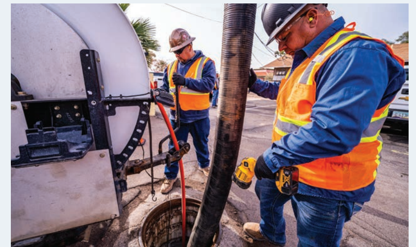
Los técnicos de servicios públicos hacen mantenimiento en el sistema de recolección de aguas residuales, lo que evita obstrucciones de alcantarillado que puedan presentar un riesgo para la salud y el medio ambiente.
